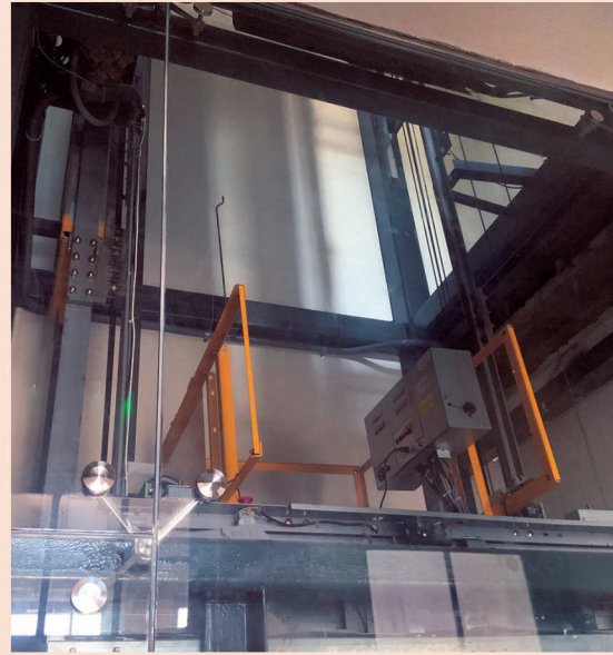
圖5：博物館 2020 年新安裝之電梯，為安裝電梯敲除原有樓板，雖不符合可逆性原則，卻更欲達到文化平權之普世價值。
